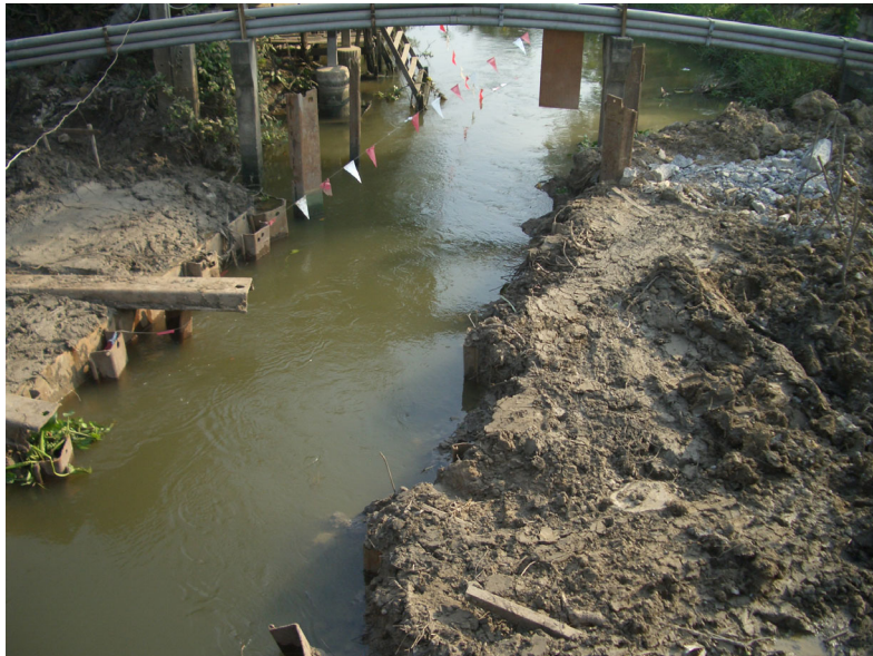
รูปที่ 4-1 สภาพร่องน้ำที่จะก่อสร้างสะพาน
