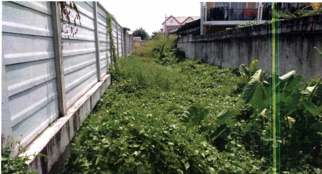
รูปก่อนดำเนินงานก่อสร้างถนนหินคลุก พร้อมวางท่อระบายน้ำ บริเวณหลังหมู่บ้านวรัญญาเชื่อมถนนตำบลดอนหัวฬ่อ ม.๔ ต.นาป่า
